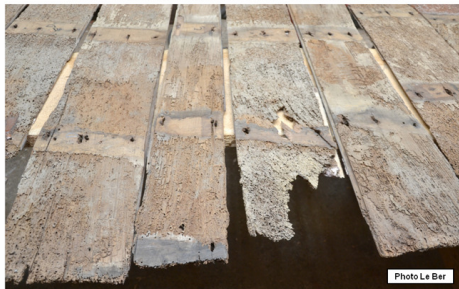
APRÈS NETTOYAGE, LES PLANCHES SONT CONSOLIDÉES AVEC DE LA RÉSINE. APRÈS PASSAGE À LA RABOTEUSE, ON OBTIENT UNE ÉPAISSEUR RÉDUITE ET UNIFORME AVANT LEUR COLLAGE SUR DU BOIS NEUF.
